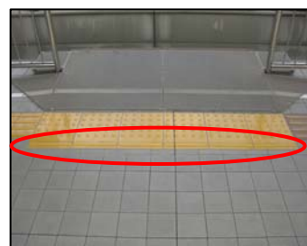
ホーム縁端警告ブロック
