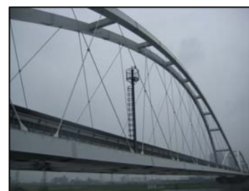
淀川橋梁風速計
